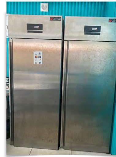
Elementos necesarios para la mejora del local: - Paneles blancos para cubrir oxido neveras.
